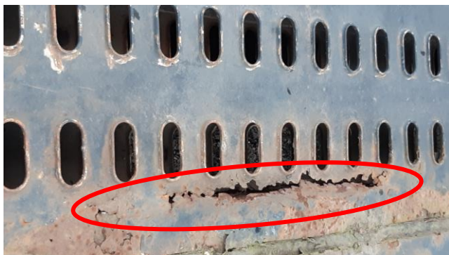
Figure 1A : oxydation traversant le platelage
