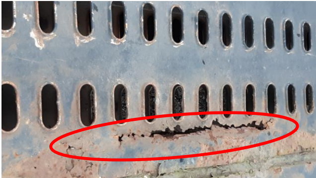
Abb. 7 : Oxidation durch das Fahrbahnelement
